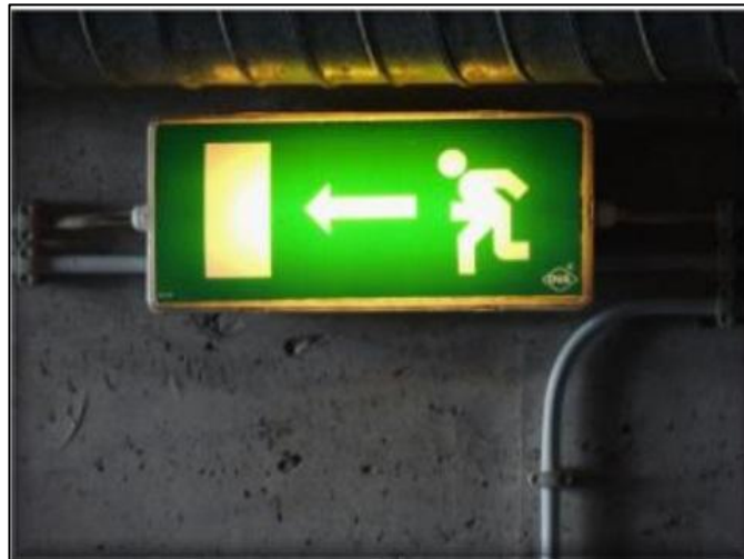
Figura 9 - Sinalização iluminada com fonte de luz própria
