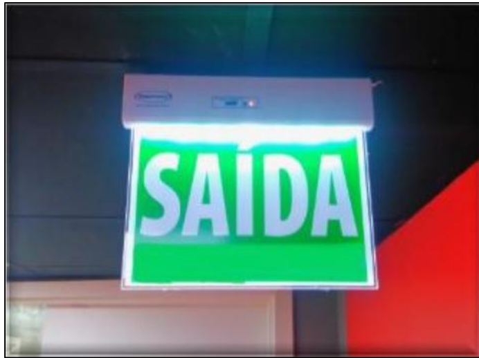
Figura 8 - Sinalização iluminada com fonte de luz própria
